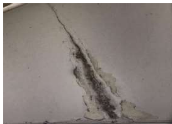
Eclats de béton en sous-face des balcons
