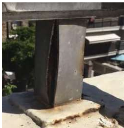
Eclatement d'un pied aluminium de garde-corps
